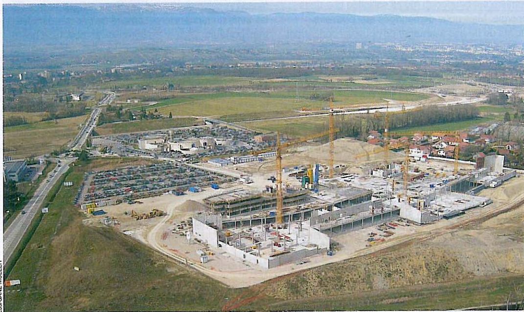
Entreprises françaises et suisses travaillent ensemble sur ce chantier de 70 millions d'euros pour 40000 m 2 d'activités.
